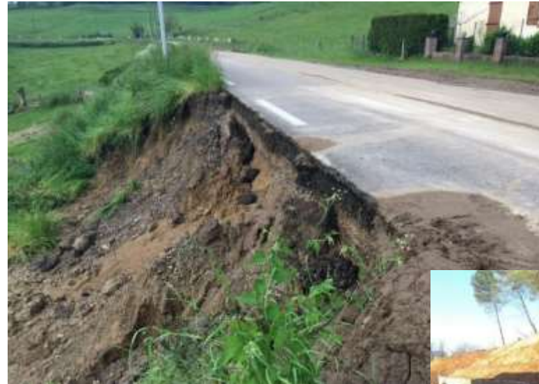
Erosion des remblais, talus et fondations
