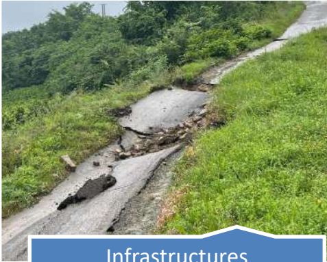
Infrastructures prématurément vieilles, dégradées ou détruites
