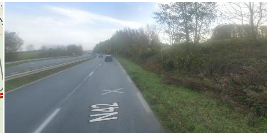
Absence d'accotement revêtu et donc de possibilité de récupération et largeur d'accotement comprise entre 0,91m et 1,23m
